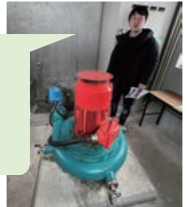
定格出力19.9kWの水車と発電機
