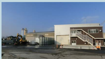
リサイクルエコプラント工場
